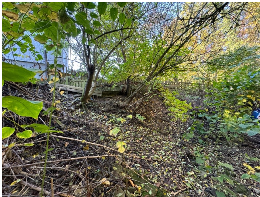
Fot. 2. Górna część osuwiska - skarpa główna - dochodząca do ogrodzenia posesji.
