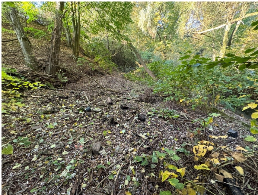
Fot. 1. Całkowicie zniszczone stare umocnienia na jęzorze osuwiska, zaciśnięcie koryta przez materiał koluwalny.
