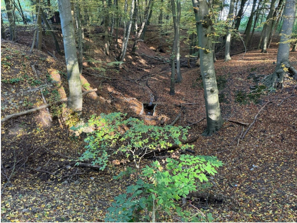
Fot. 4. Widok przepustu u podstawy osuwiska.
